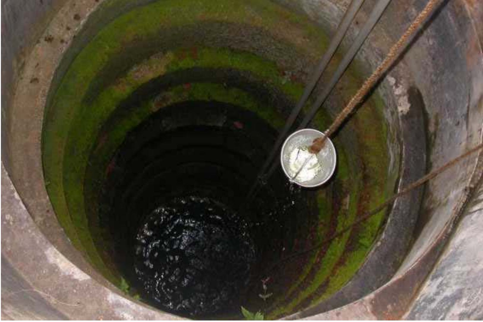
ÁGUA DE POÇO*
