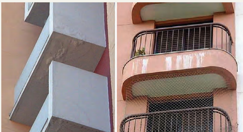
Figura 27 - Patologias em terraços por infiltrações de água em pisos sem impermeabilização.
