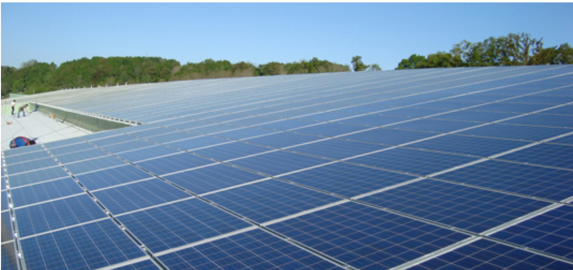
Telhados fotovoltaicos também podem ser considerados telhados verdes.
